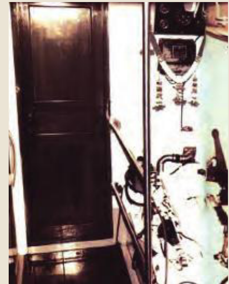
ห้องเครื่อง Engine Room
