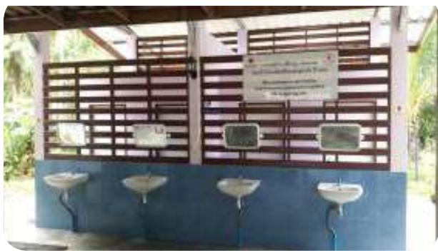
ห้องน้ำศาลากลางหมู่บ้าน (จุดปลอดภัย) หมู่ 9 ตำบลบางมะพร้าว อำเภอหลังสวน จังหวัดชุมพร Toilet at Community Hall (Assembly Point) of Moo 9, Tambon Bang Maphaw in Lungsuan District of Chumphon Province.
